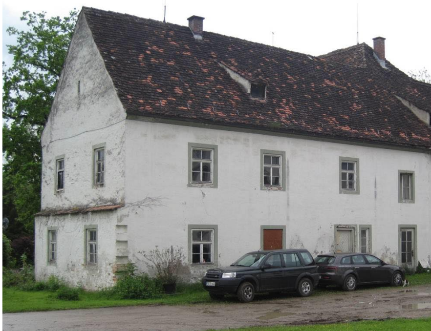
Abb. 8: Südbau Ansicht von Südosten An der Gebäudeecke: Ausbildung sog. „Wartesteine“ (Hinweis auf die geplante Fortführung des Baukörpers)
