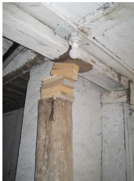
Abb. 33: Kopfbau: Abstützung Unterzug östl. EG
