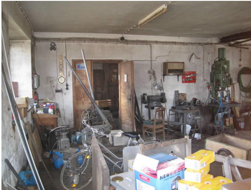
Abb. 14: stark gerissene Wand EG Kopfbau (Werkstatt)
