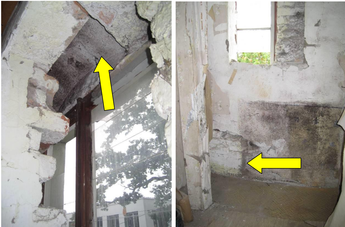
Abb. 43, 44: Kopfbau OG Raum 1.10: mittiges Fenster Westseite Kalkschlämme am Sturz, Betonsturz über Türöffnung EG
